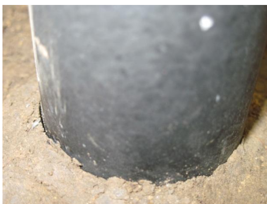
Рисунок 6 - Горизонтальное смещение свайной опоры и образование зазора между ней и грунтом
