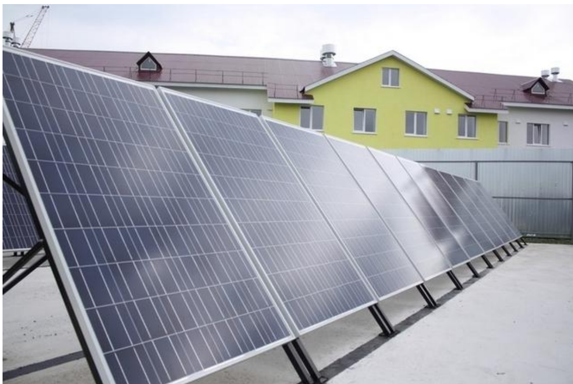
Рисунок 1. Солнечная фотоэлектрическая батарея
